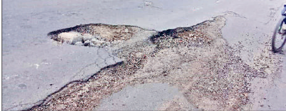
रोहतक। शहर के मुख्य मार्गों की टूटी सड़कें।
